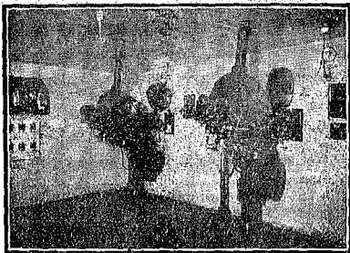
Vista parcial de la cabina de proyección. Se distinguen los dos proyectores.
